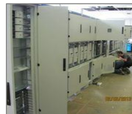
Главный распределительный щит
